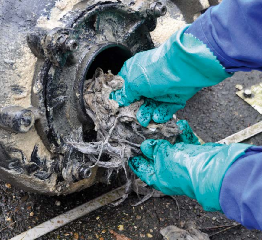
Verstopfte Pumpen, aufwändige Instandstellung.
